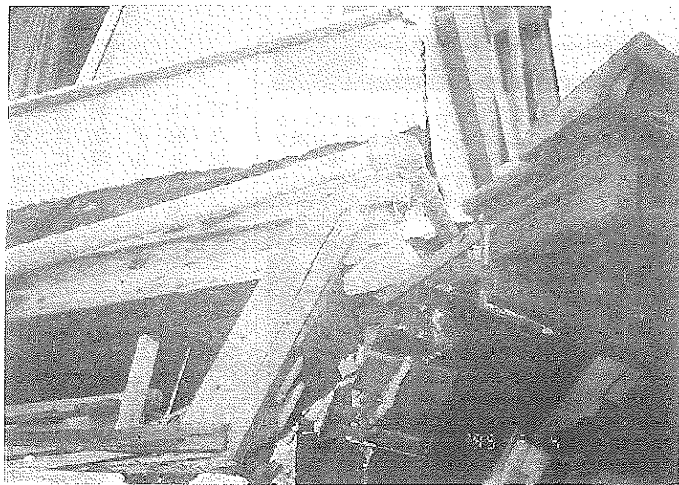
壁が足りなざらことで、応力が通し柱の接合部へ集中、通し柱が折れた。
